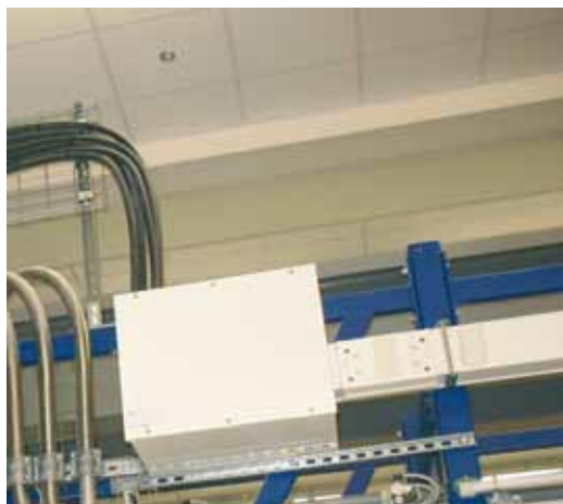
Шинопровод Canalis KS и спринклер
