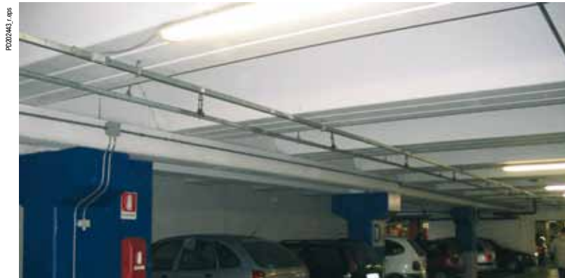
Шинопровод Canalis KBA со светильниками и спринклерами
