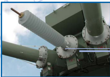
DTOI 123 kV – 1250 A
