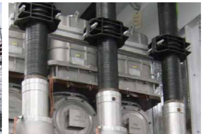
Подключение к ячейкам КРУ с изоляцией SF6 (элегаз)
