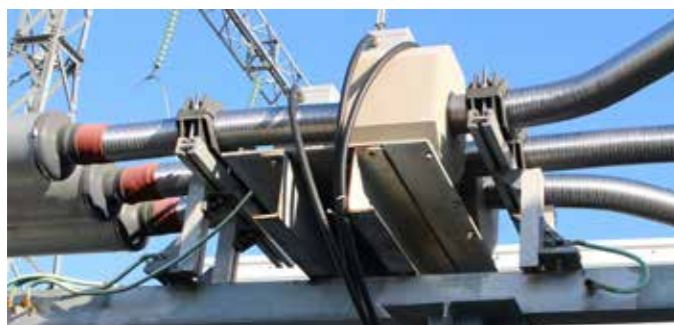
Пример установки трансформаторов тока
