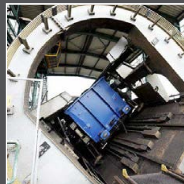
Троллейный шинопровод на вагоноопрокидывателе, Австралия
