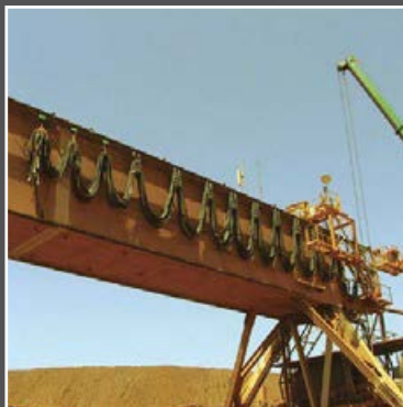
Подвесная система на мостовом перегружателе, Австралия
