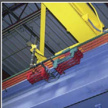
Шинопровод на обслуживающем кране, Китай
