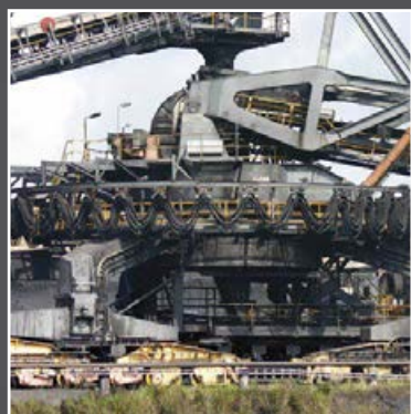
Подвесная кабельная система на Стакере/Реклеймере, Австралия
