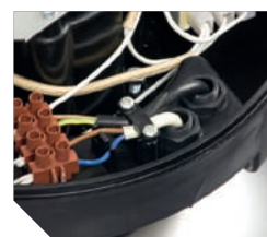
Подвод питания для рабочей и аварийной ламп
