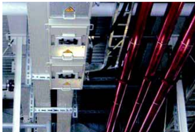
Низкая пожарная нагрузка распределительных шинопроводов
