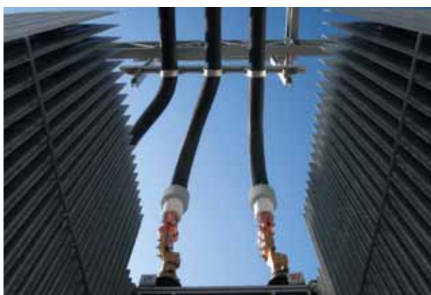
Подключение к трансформатору, наружное исполнение
