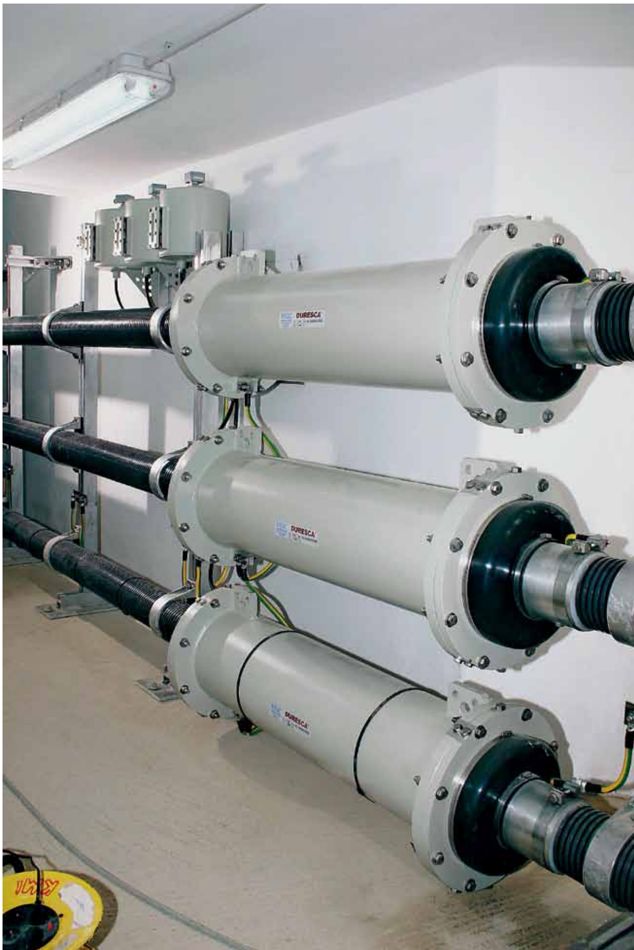
Токопровод DURESCA 123 кВ 2000 А
