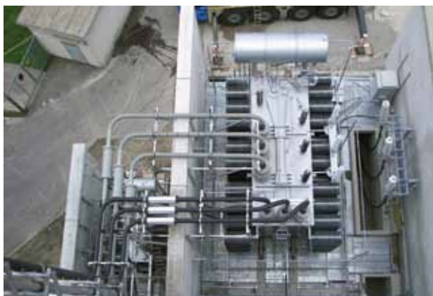
Подключение к трансформатору закрыто защитными боксами
