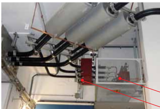
Подключение измерительных трансформаторов
